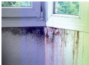
Bild 1: Schimmelbildung im Fenster-Anschlussbereich (Foto: H. Scheller, Goslar)
