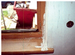
Bild 2: Durch Malerarbeiten verursachte Verunreinigung (Foto: H. Scheller, Goslar)
